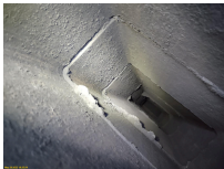
flue joint voids .jpg flue joint voids .jpg
